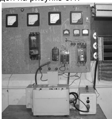
а) электрический щит установки
