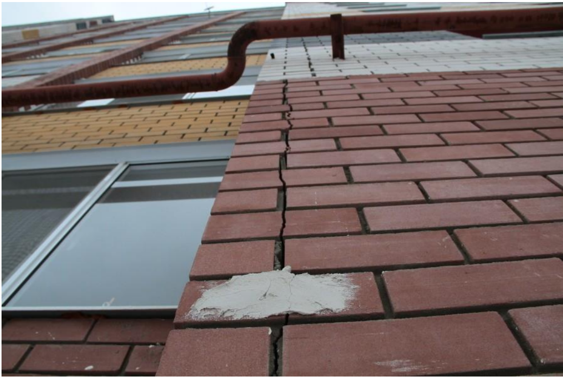
Рисунок 1. Трещина на стене одного из домов в г. Казани
