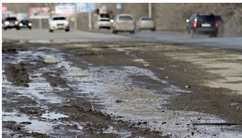
Рисунок 1 – Состояние участка дорожного полотна и обочины в весенний период
